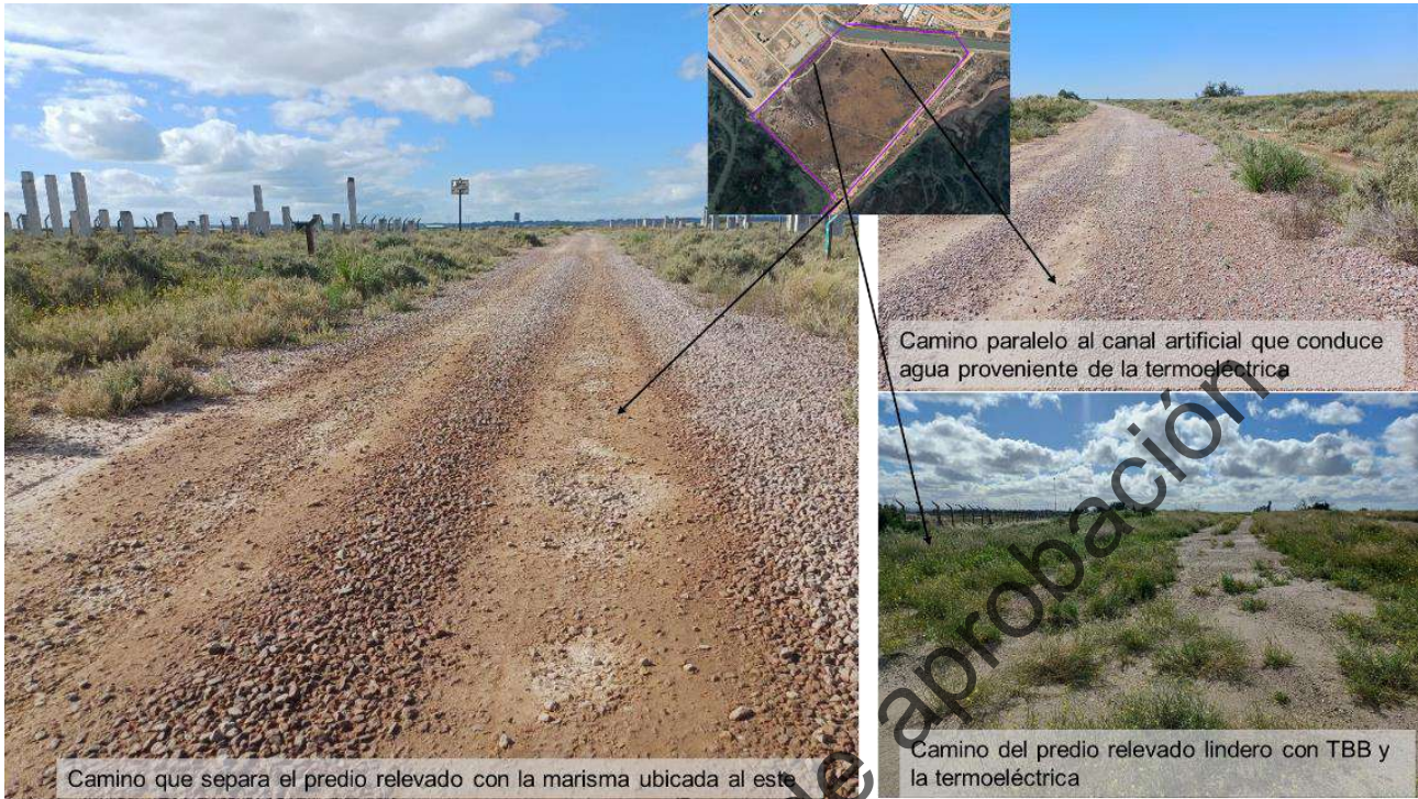
Figura 79. Estado de los caminos que rodean al terreno.
