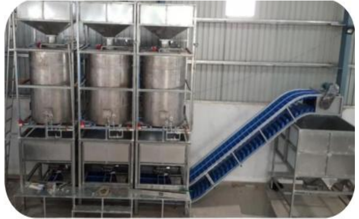
Photo 4 : Ascenseur de collecte
