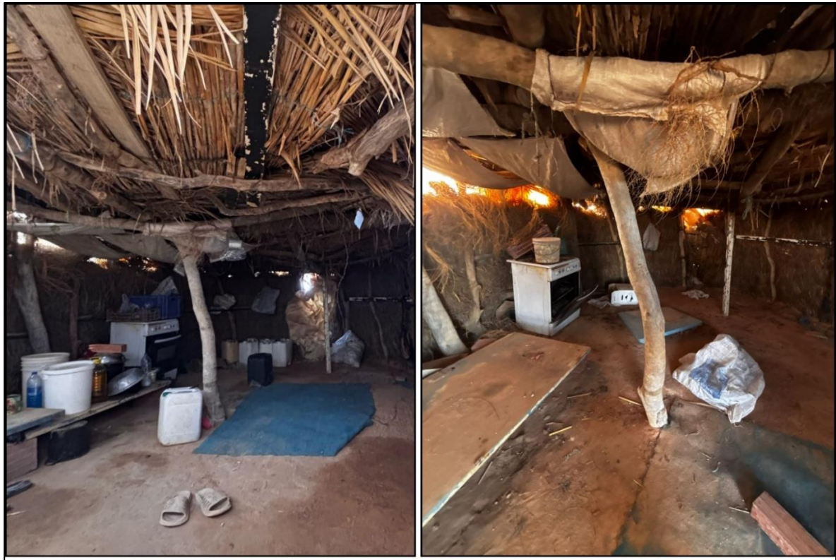
Figure 4 : Photos d'une des cabanes affectées : entre avril et septembre 2025
