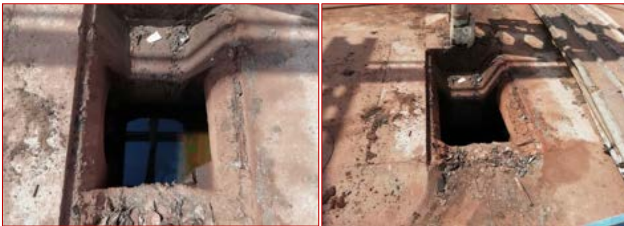
Quelques ouvrages de drainage d'eau pluviale existants sur le site du projet (Images du 03/10/19)
