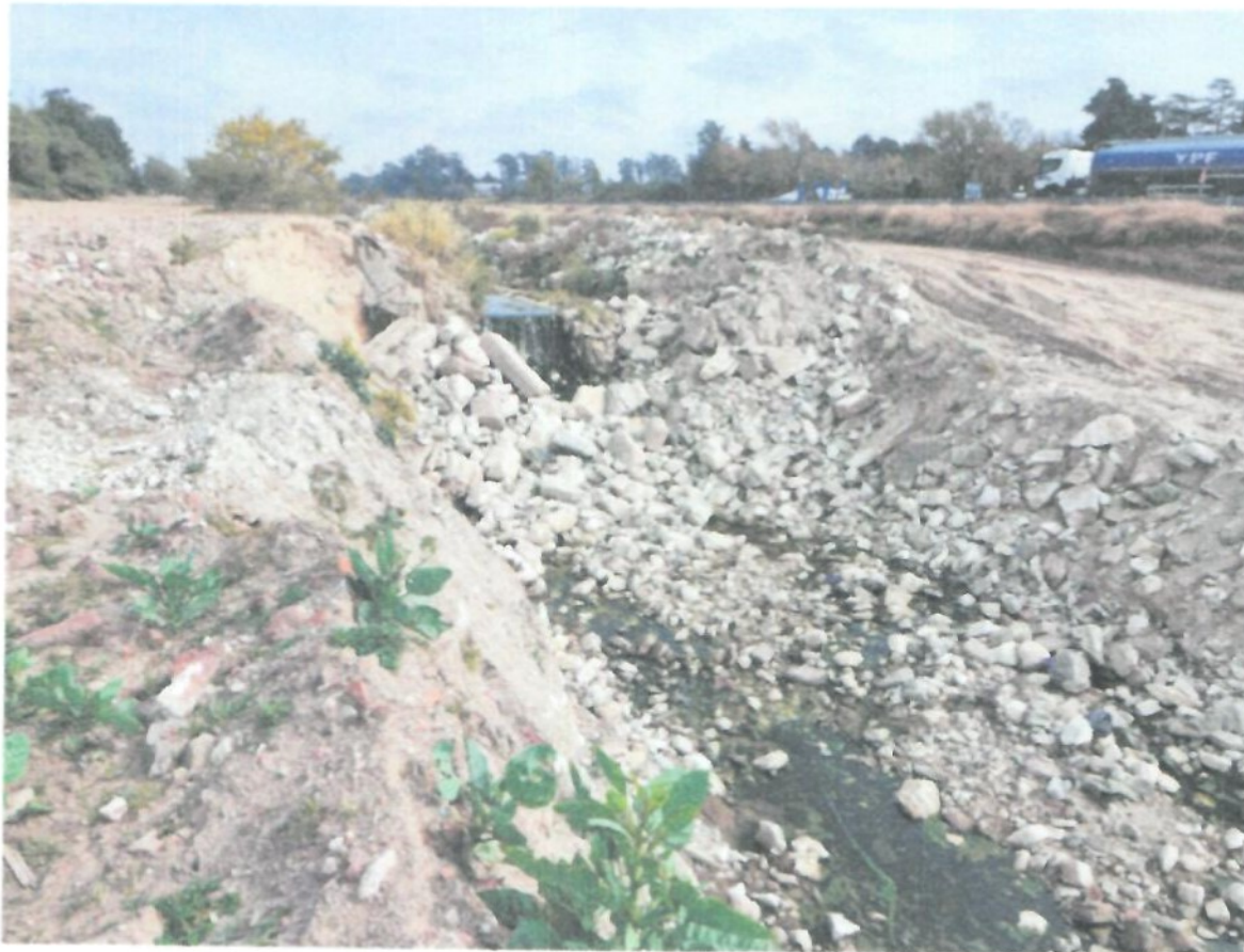
Figura 20: Imagen del Canal, en el sector del salto hidráulico generado por la erosión- Se observa el enrocado que otorga rugosidad elevada al canal.
