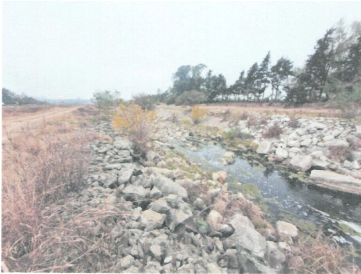
Figura 19: Imagen del Canal, aguas arriba del tramo analizado, se observa el enrocado que otorga rugosidad elevada al canal.
