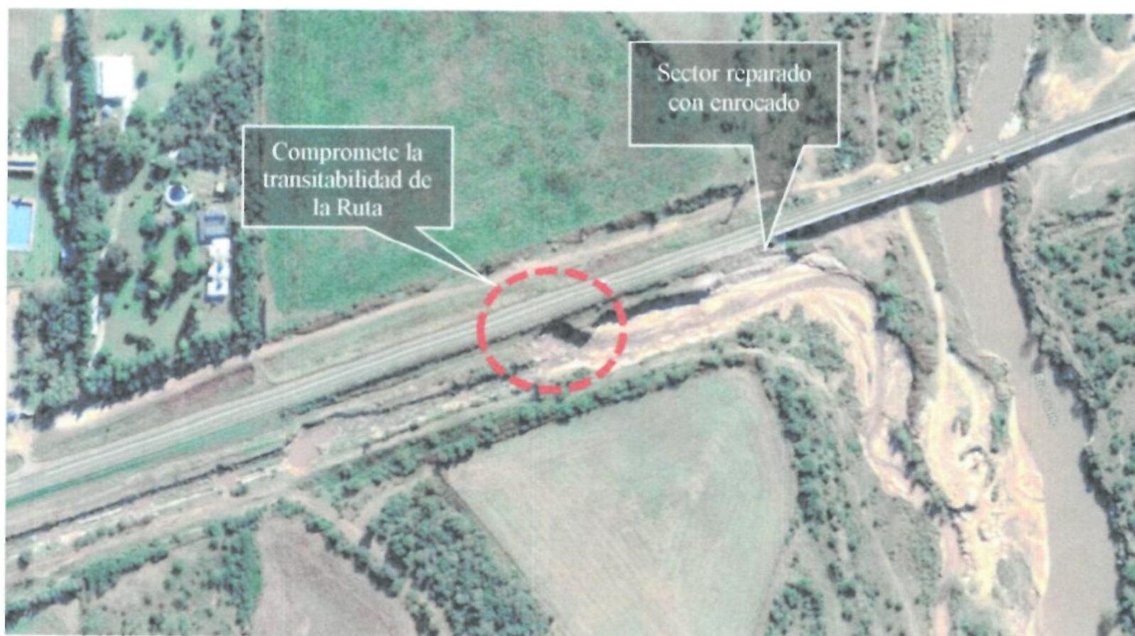
Figura 4: Avance cronológico del proceso de erosión (mayo 2019). La erosión compromete la transitabilidad de la Ruta.
