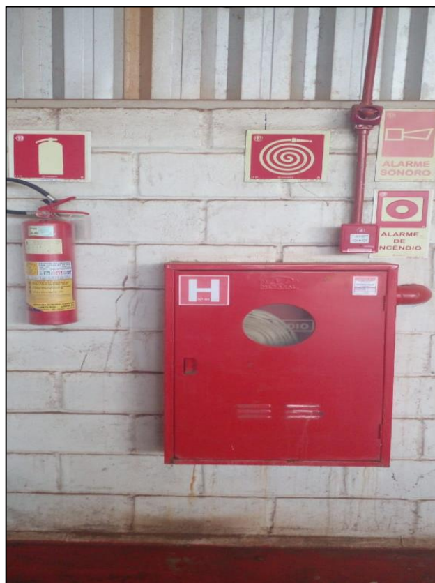
Fotografia 2 – Sistema de Incêndio.
