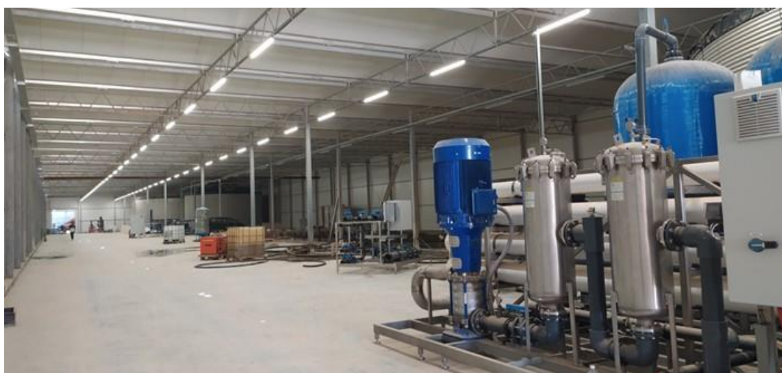
Figure 3 : Photos de la composante station de dessalement de la première phase du projet
