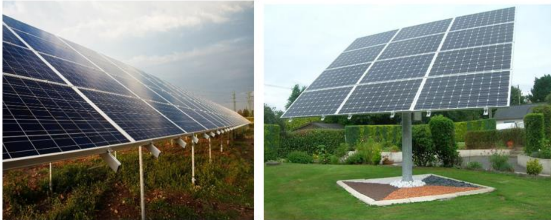
Figure 12: Installation solaire avec support fixe (1) et avec Tracker (2)
