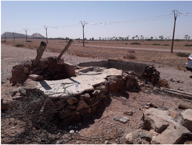
Figure 23: Point d'eau abandonné et non équipé au sein du terrain OCP
