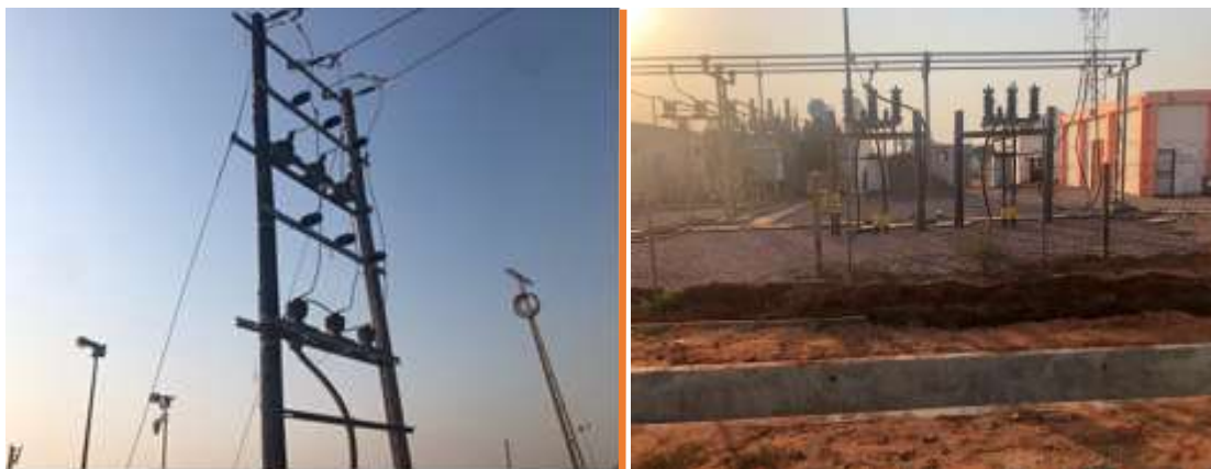
Figuras 4 e 5. Central Eléctrica de Beluluane
