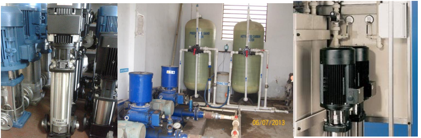
شكل (10). مضخات الضغط العالي (High pressure pump) المستخدمة فى محطة التحلية.
