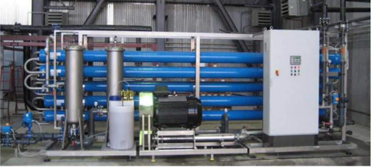
شكل (12). جهاز إسترداد الطاقة (Energy Recovery Device) المستخدمة في محطة التحلية.
