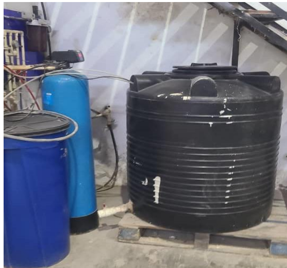
Photo 6. Système de filtration et de traitement de l'eau
