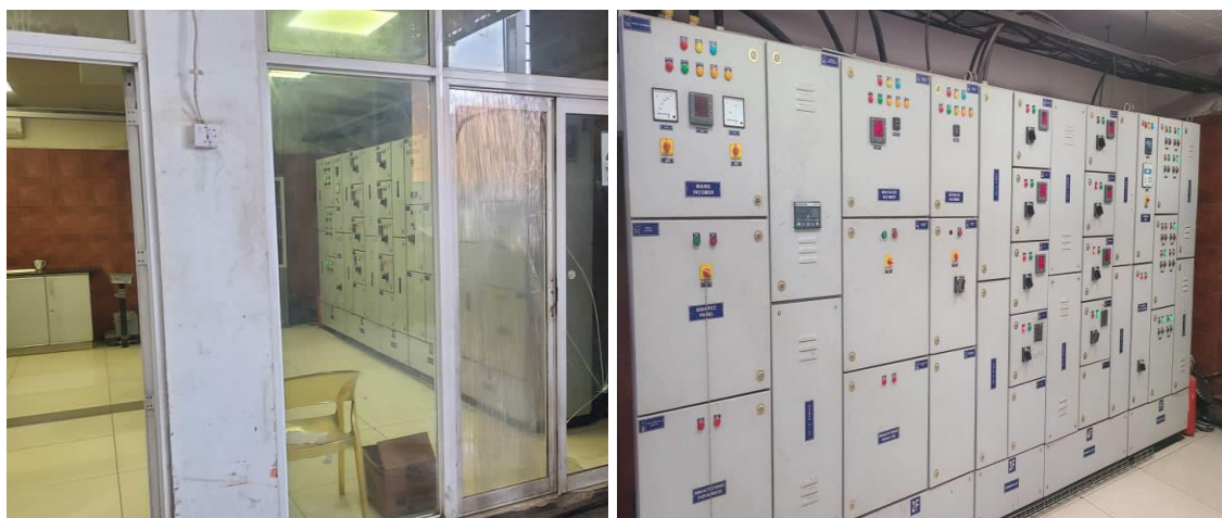
Photo 7. Cabine électrique de la minoterie
