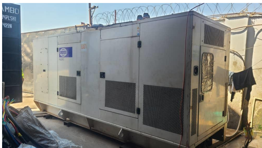
Photo 8. Groupe électrogène utilisée dans la minoterie
