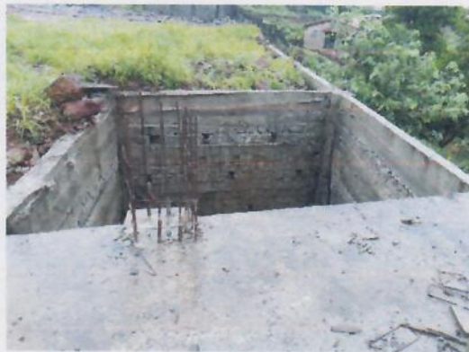
5-Bassin de rétention des eaux et huiles usées
