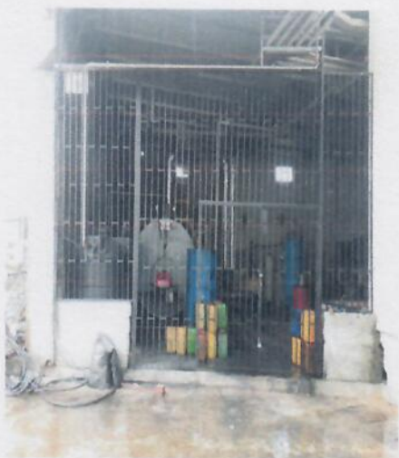
1-Photo de la chaudière
