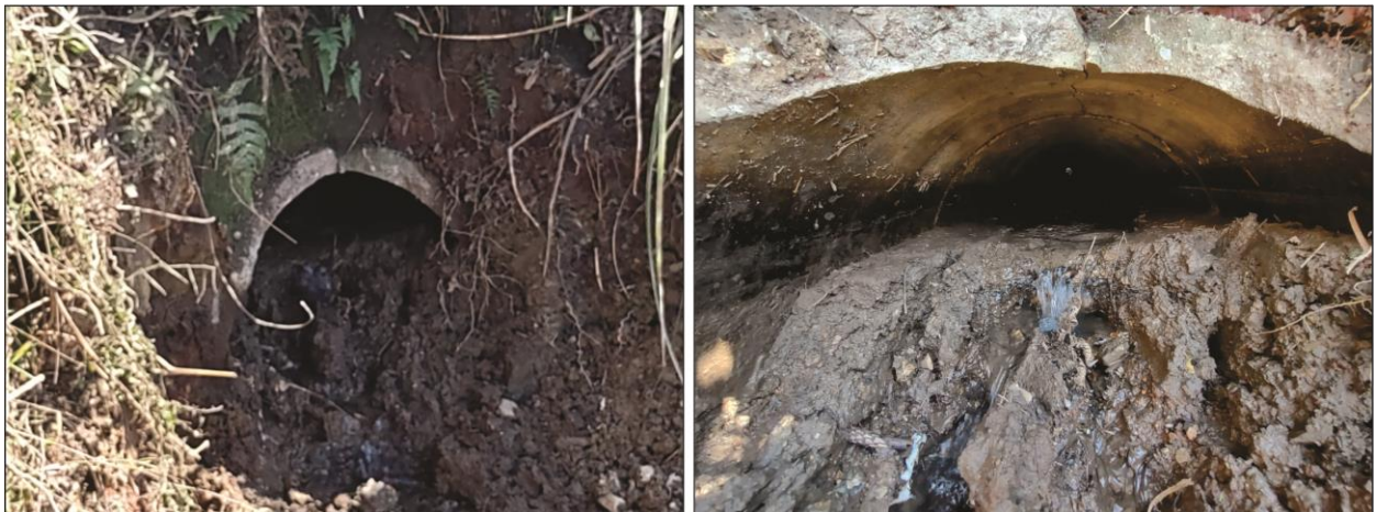
Foto 7. Tubulação localizada na base do aterro da rodovia SC-114. O terminal da tubulação estava recoberto por terra. Observar a obstrução do diâmetro interno. À foto da esquerda mostra o contexto externo da tubulação e a da direita mostra em detalhe a obstrução na parte interna da tubulação.
