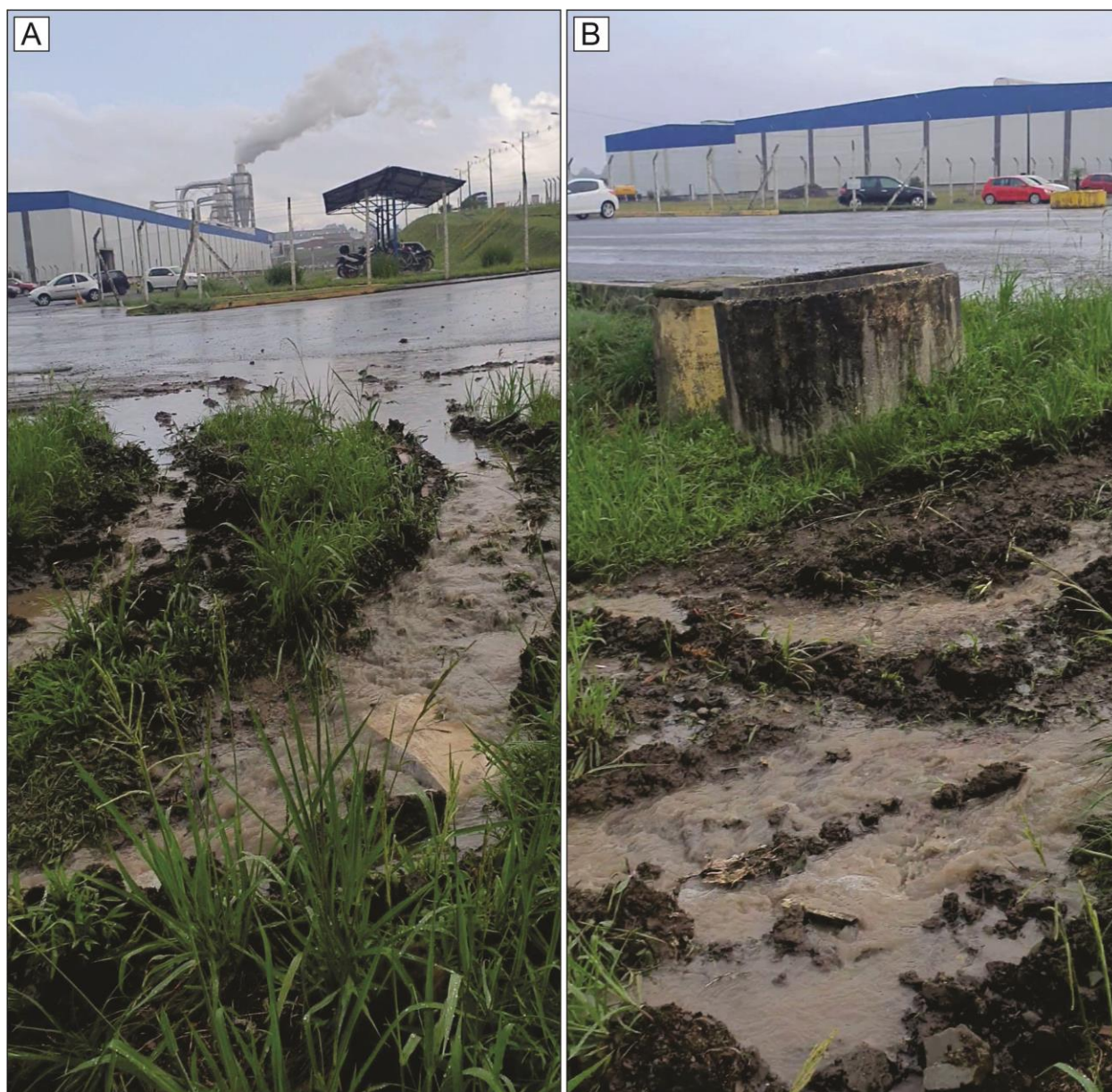
Foto 10. Chuva registrada em 10/03/2022. A) Escoamento superficial da água de chuva ao lado da caixa de passagem e que segue em direção ao terminal da drenagem localizada a jusante. B) Escoamento superficial no entorno da caixa de passagem.
