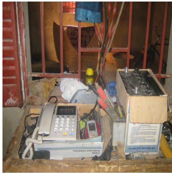
Poste de téléphone Wassa à Djikoye Photo 24
