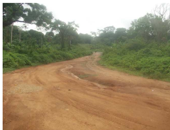
Figure 2 Route au village Ndji à proximité du site du chantier de l'Usine
