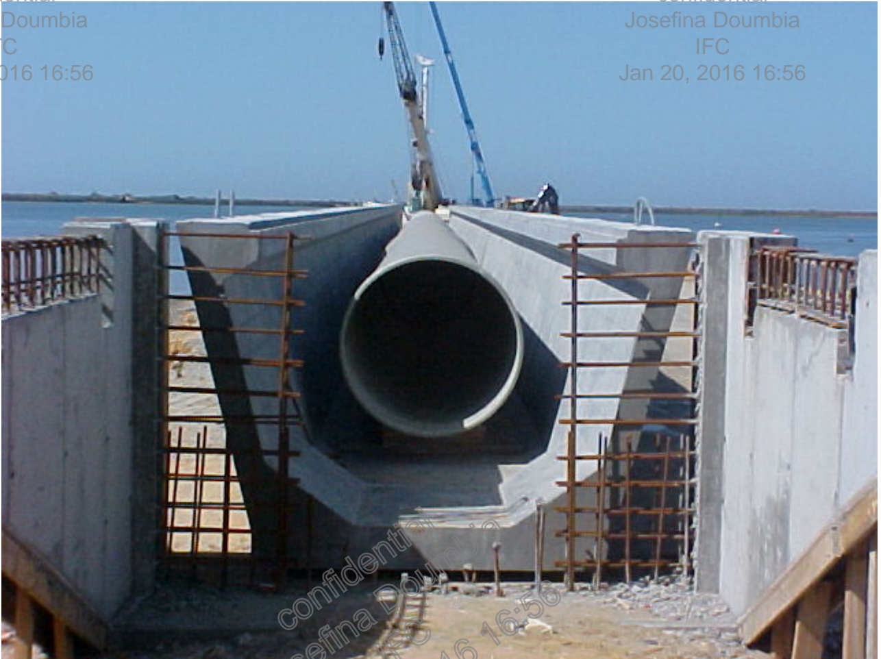
Figura 13. Vista de detalle de disposición de la tubería de captación en el pantalán formado por vigas artesas
