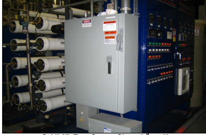
Şekil 67. Ters Osmoz Sistemi Örneği
