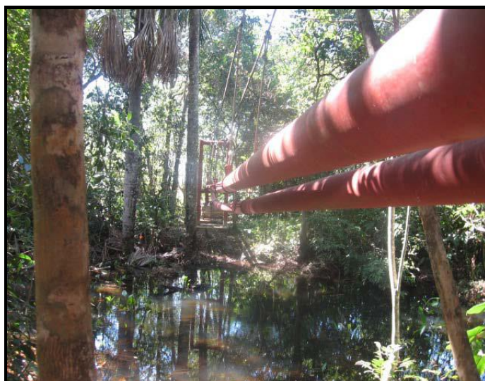
FOTOGRAFÍA 3.58 CAÑO GUARROJO. CORREDOR DE LÍNEAS DE FLUJO DE FACILIDADES PRODUCCIÓN CARACARA SUR – ESTACIÓN JAGUAR
