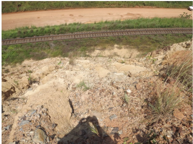
Figure 17: Zone à risque d'érosion au PK287+800 (Mont Brazza)
