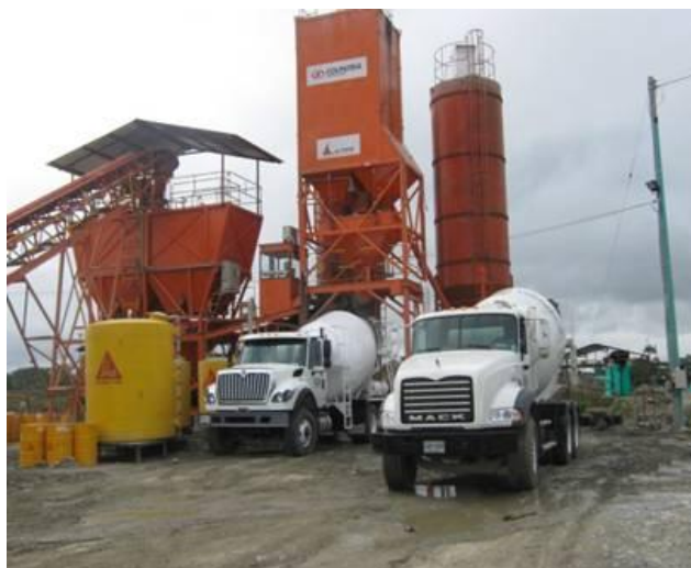
Foto 3. Planta de Concreto
