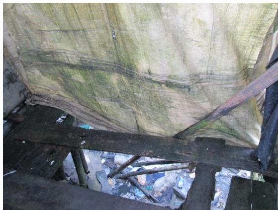
Foto 22. Hueco utilizado como sanitario (campo abierto)
