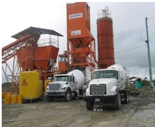
Foto 5. Planta de Concreto
