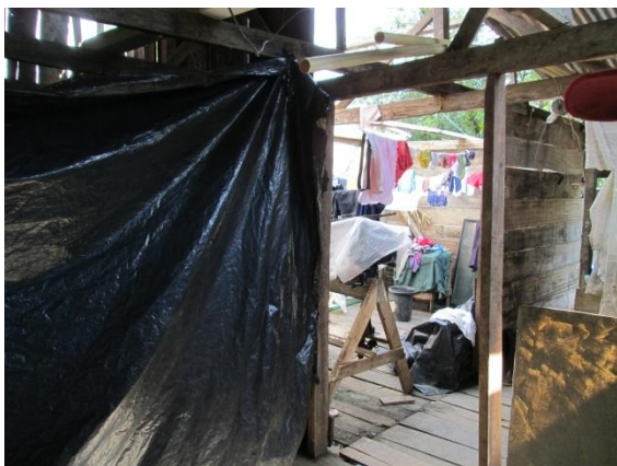
Figura No 40. Vivienda sin techo y con paredes de plástico
