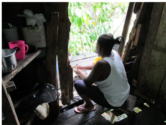
Figura No 41. Vivienda con piso y paredes averiadas
