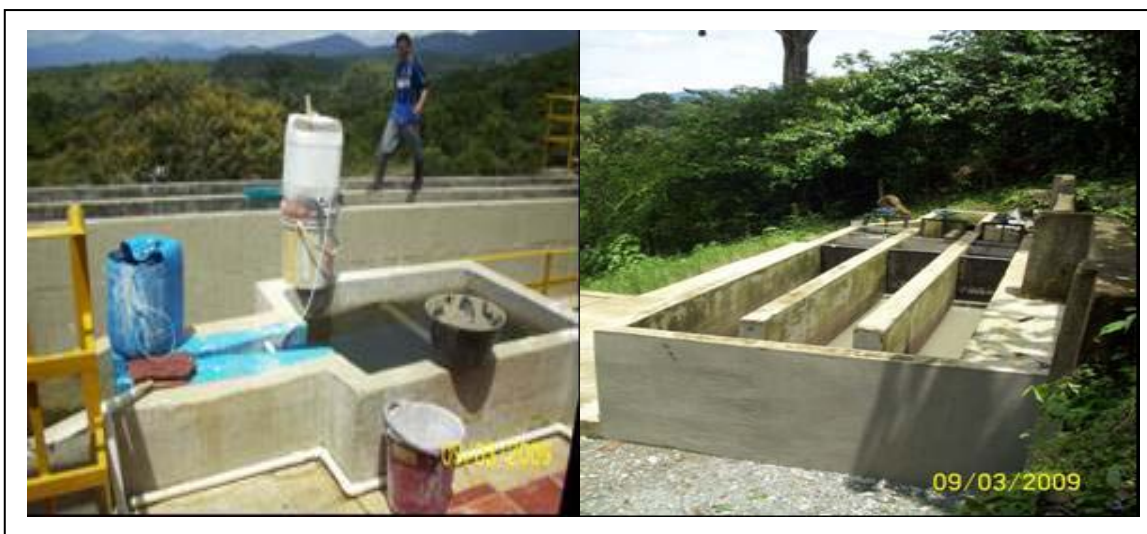
Fotografía 2-40. Sistema de acueducto municipal de Uribe
