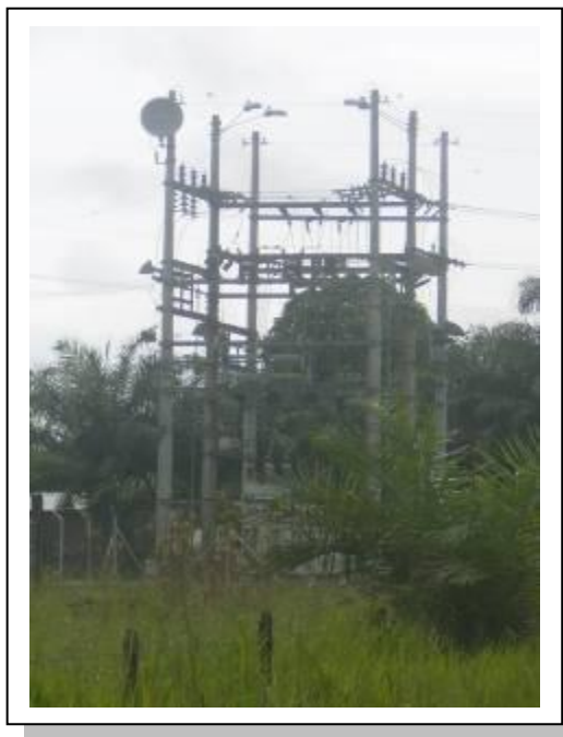
Fotografía 2-57. Subestación eléctrica a la salida de Puerto Guzmán – Puerto Rosario
