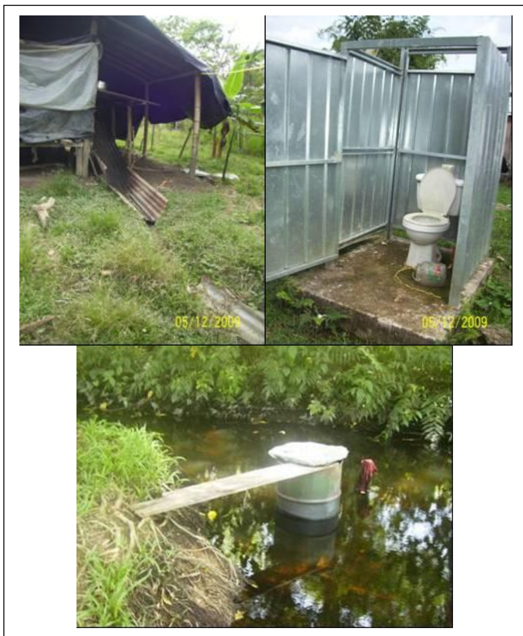
Fotografía 2-74. Sistema de vertimiento de aguas residuales, batería sanitaria y lavadero en caño de la vereda El Caraño, y en vivienda de la vereda Trojayaco
