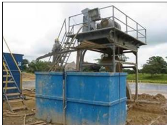
Fotografía 7-4. Unidad dewatering tipo empleada en pozo
