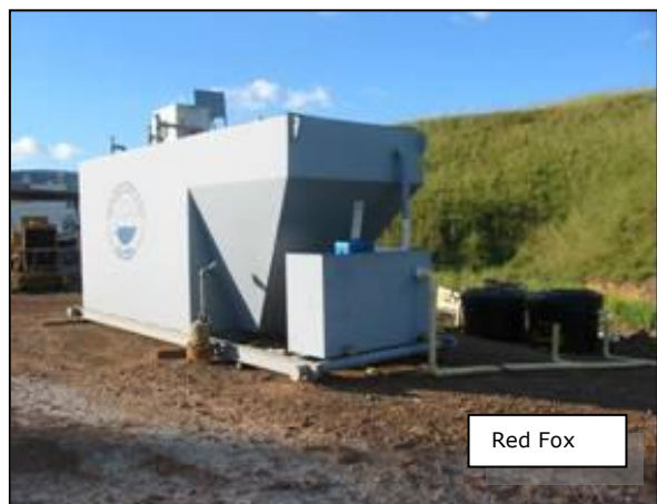
Fotografía 4-4. Sistema de tratamiento de las ARD para perforación y pruebas de producción (Red Fox)
