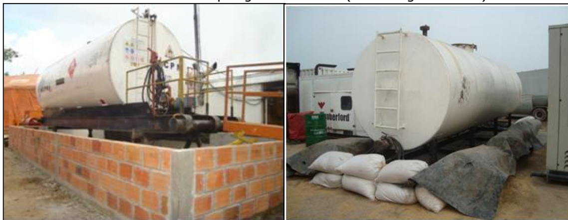
Fotografía 2-39. Almacenamiento tipo de ACPM
