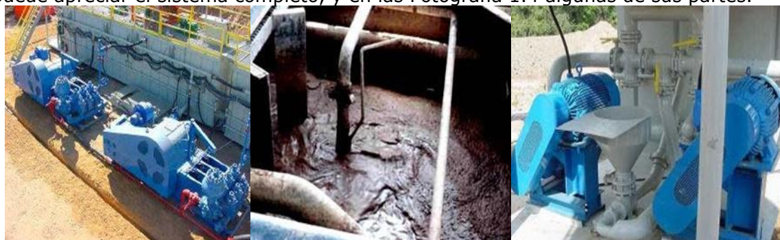
Fotografía 2-45. Sistema de Lodos
