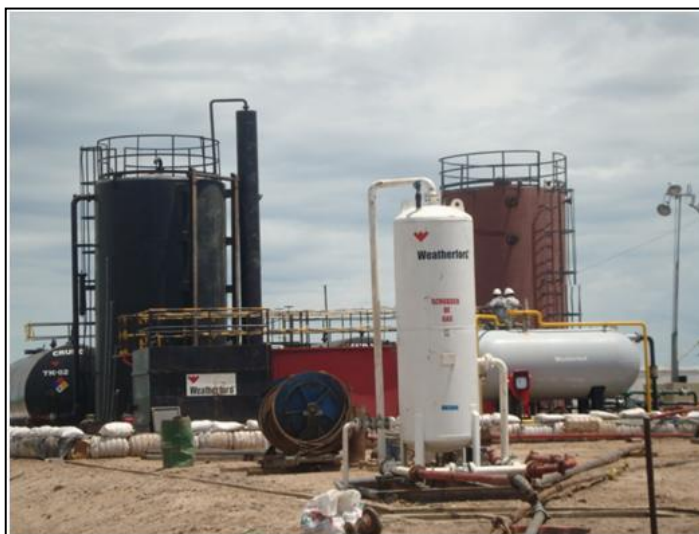
Fotografía 2-50. Equipos instalados en la etapa de pruebas de producción
