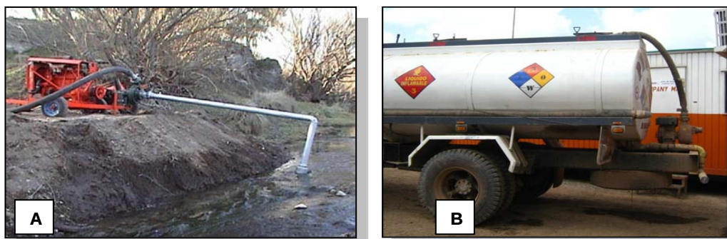
Fotografía 4-5. Sistema de captación y conducción de agua potable tipo. A) Motobomba y manguera. B) Carrotanques.
