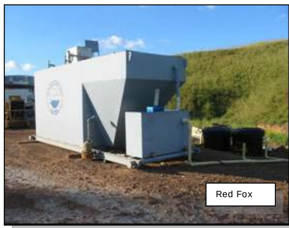
Fotografía 4-7. Sistemas de tratamiento de las ARD para perforación y pruebas de producción (Red Fox)
