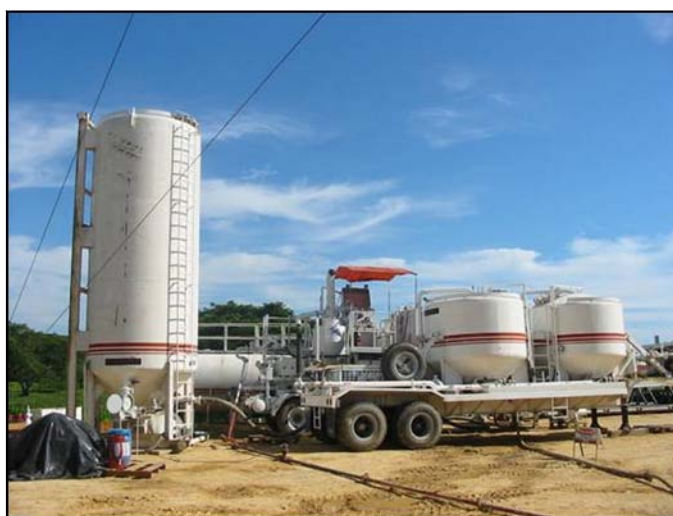
Fotografía 2-34. Equipo de cementación utilizado en perforación
