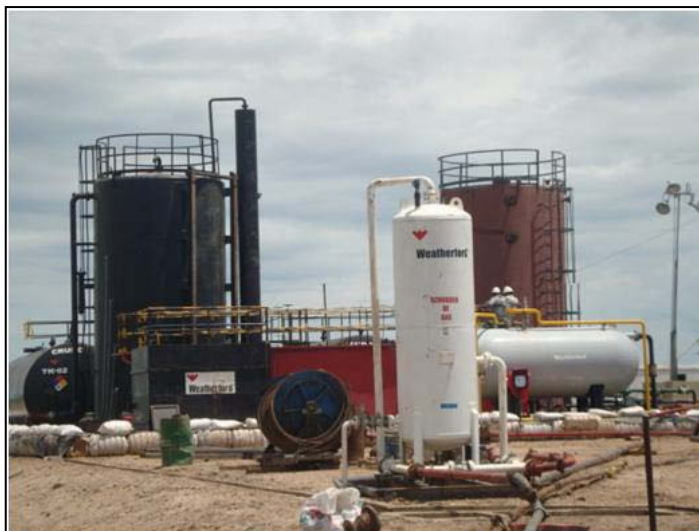
Fotografía 2-36. Equipos instalados en la etapa de pruebas de producción
