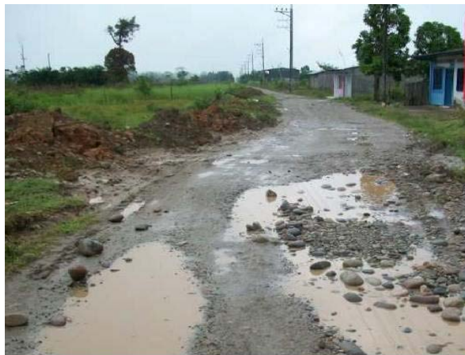
Fotografía 2-4. Identificación de baches en el K10+000 (vereda el Bombón)
