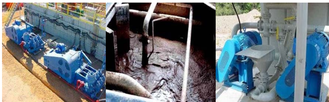
Fotografía 2-31. Sistema de Lodos
