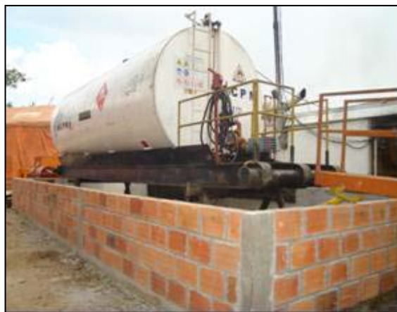
Fotografía 2-24. Almacenamiento tipo de ACPM
