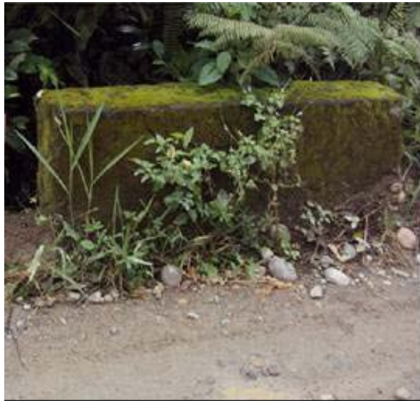
Fotografía 2-3. Identificación de alcantarillas enmalezadas en la vía Puerto Guzmán – El Bombón (K1+530)
