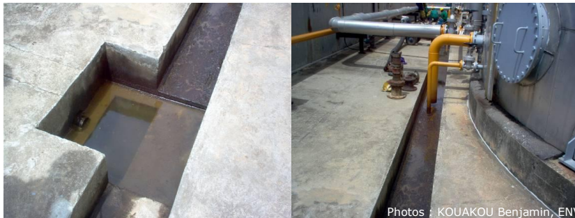
Figure 39: Réseau de canalisation pour la collecte des eaux
