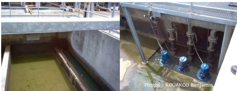
Figure 38: Vues du dispositif d'épuration des eaux usées (bassin d'orage)
