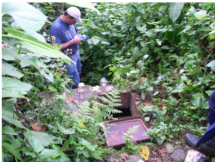
Fotografía 7.5.2.8. Captación naciente el Apache, acueducto Santa Marta.
