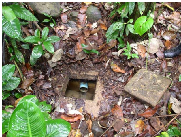
Fotografía 7.5.2.7. Captación de la naciente finca el Moro con un caudal 0,2 l/s.
