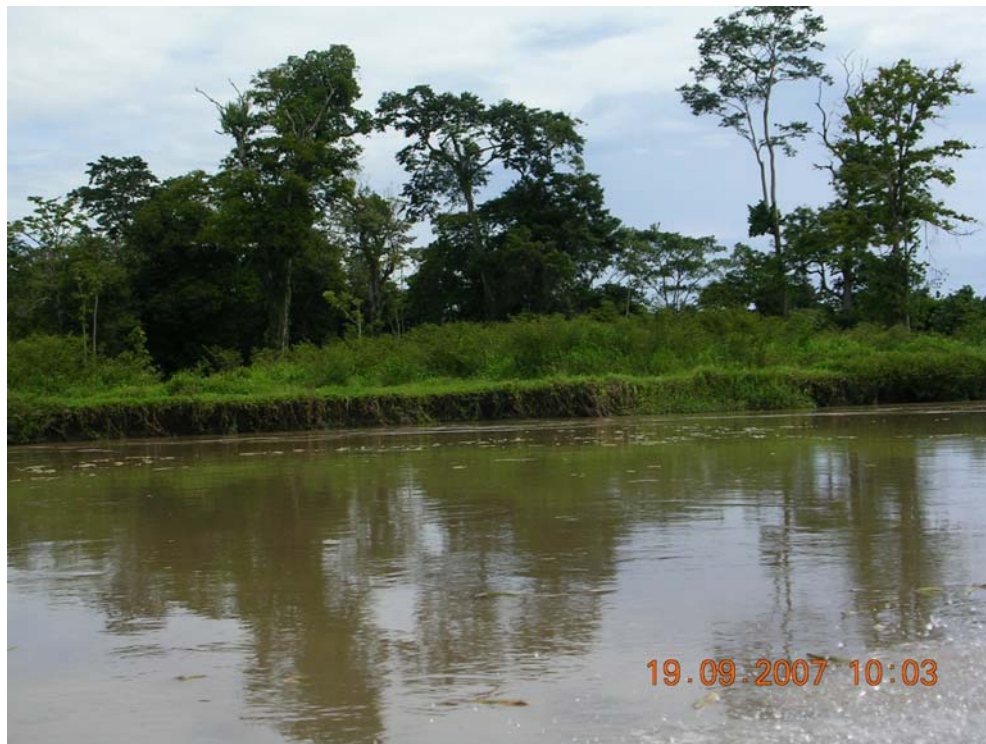
Fotografía 7.5.1.9 Erosión en la parte externa de curva.
