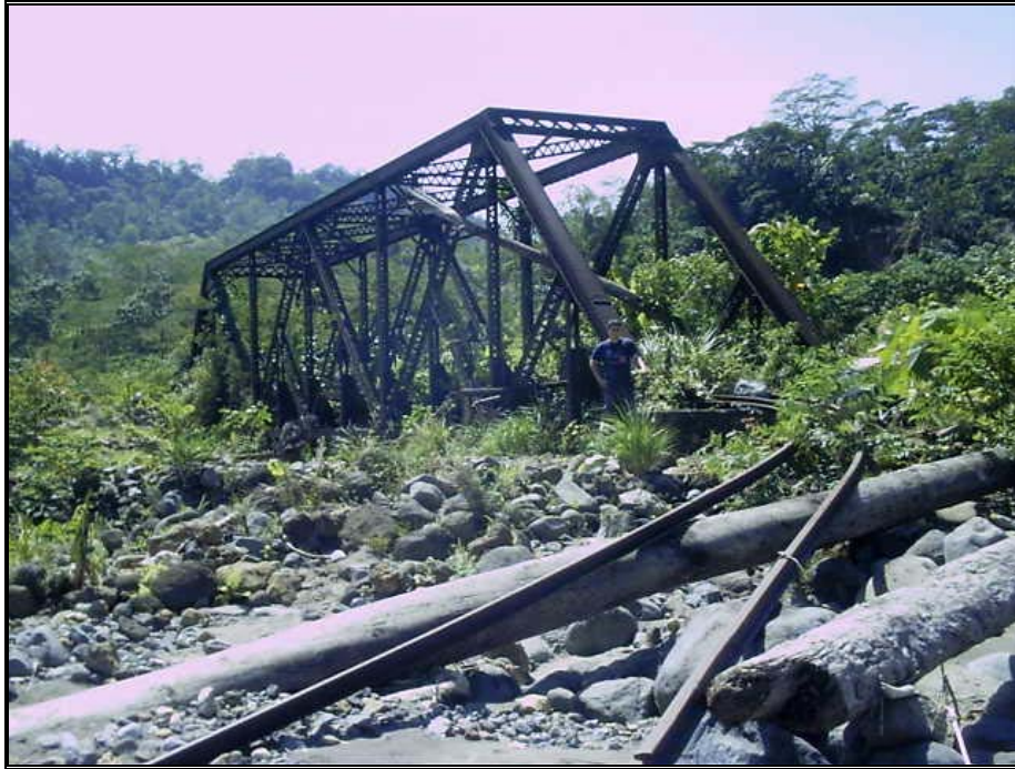
Fotografía 7.1.9. Cono de deyección: río Bonilla, invadió el puente del ferrocarril y desplazó la línea férrea.
