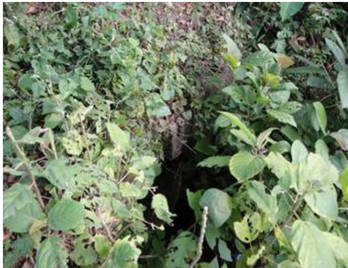
Vista del tubo de 61cm sobre el camino que va del poblado "El Chapo" al poblado "Nuevo Teapa"
