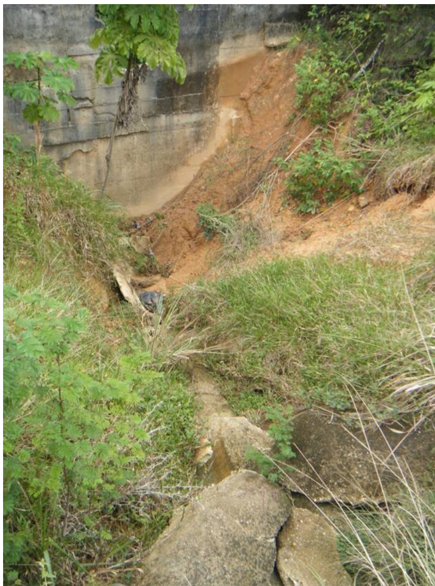
Foto 9 Vista de otro ducto existente en el sitio, es un punto bajo donde se observa derrumbe de material de relleno. Se observó agua con hidrocarburos (los ductos transportan combustible)
