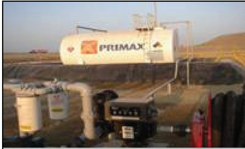
Figura 3. 25 Vista de una estación de abastecimiento de combustible
