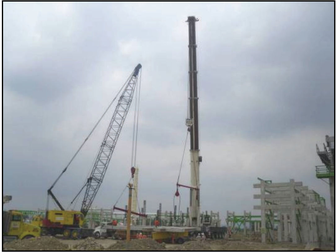
Figura 3. 30. Equipo utilizado para el ensamblado de racks
