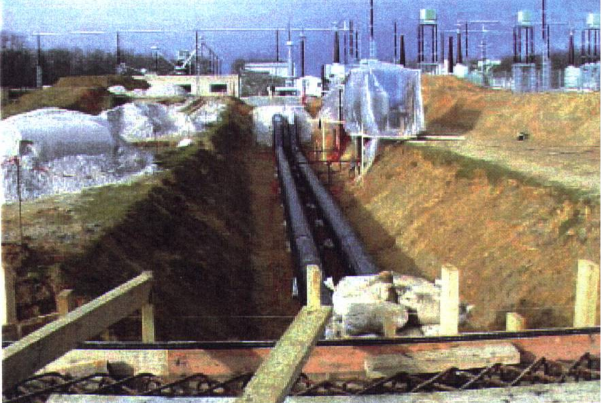
Şekil V.2.8.1. Tipik Gaz Yalıtımlı Şalt Sahası Fotoğrafı
