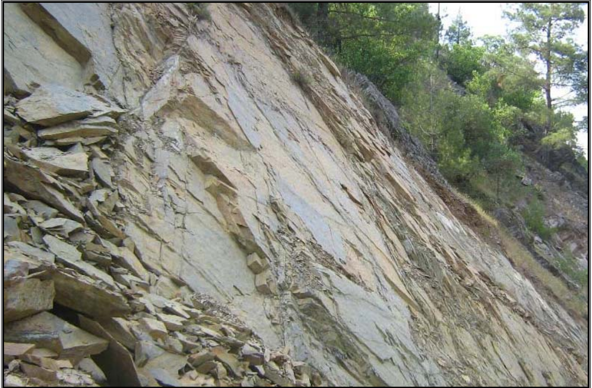
Şekil IV.2.2.2. Emirgazi Formasyonu'nun Duraysız Şeyl Seviyelerinin Göl Alanındaki Görünümü
