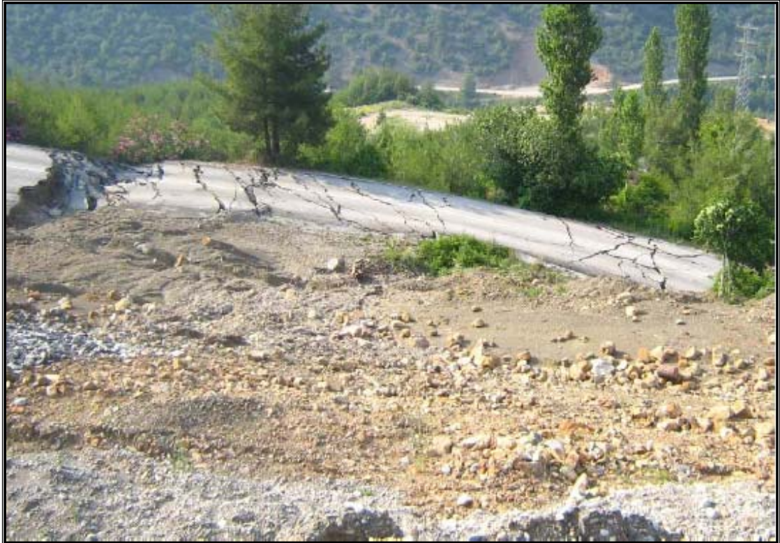
Şekil IV.2.2.5. Feke-Akkaya Köyü Yolu Üzerinde Armutludere Formasyonu İçinde Gelişmiş Heyelan
