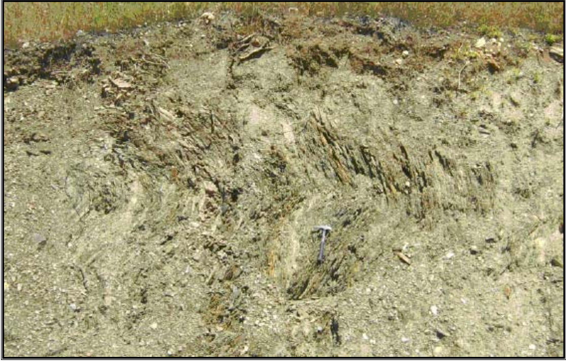
Şekil IV.2.2.4. Yol Üzerinde Armutludere Formasyonu İçindeki Ayrışmış ve Kıvrımlanmış Zonlardan Bir Görünüm
