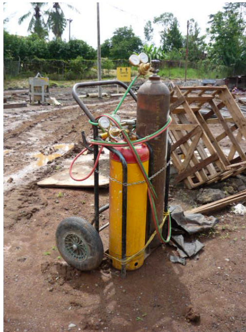
Fotografía 2 Tanques de Acetileno y Oxígeno
