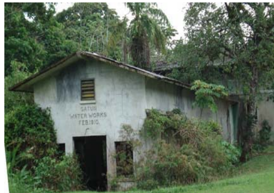
Fotografía 15: Potabilizadora de aguas
